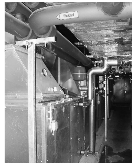
Abb. 3.1.3.1 Neue Lüftungsanlage für den Trakt »Kuttelei«
