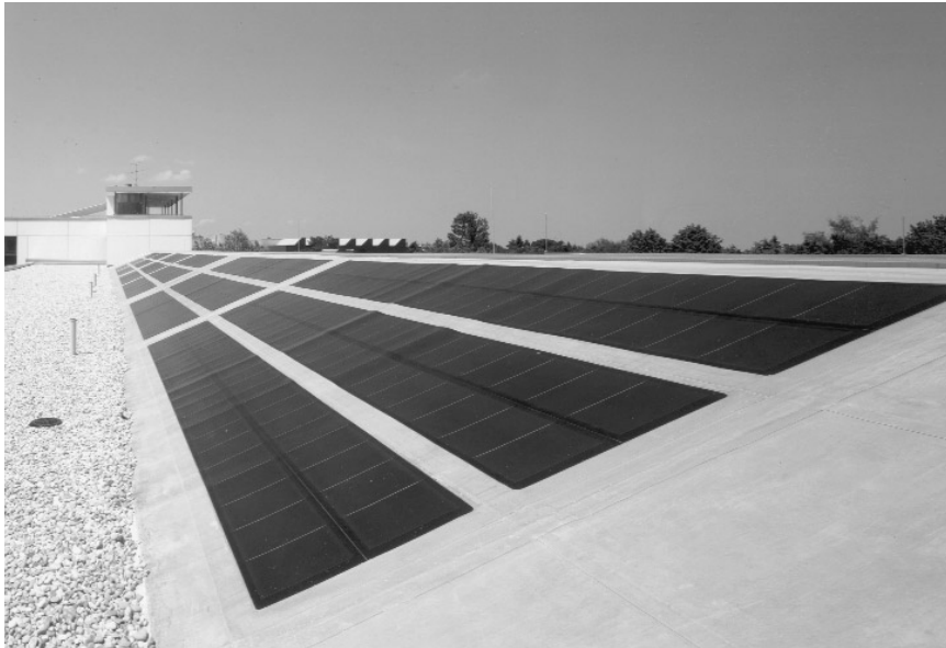
Abb. 3.2.1.4 Photovoltaikanlage, Bertolt-Brecht-Gymnasium an der Peslmüllerstraße 6 (Foto: Stephan Kässbohrer, Photo-Design, München)
