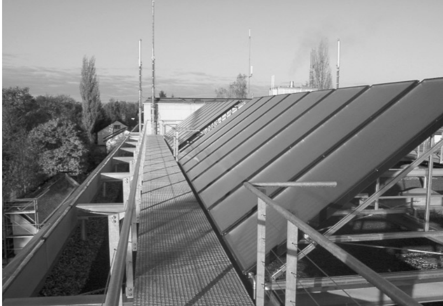
Abb. 3.2.1.1 Flachkollektoranlage 89 m 2 , Feuerwache 6 an der Bassermannstraße 20
