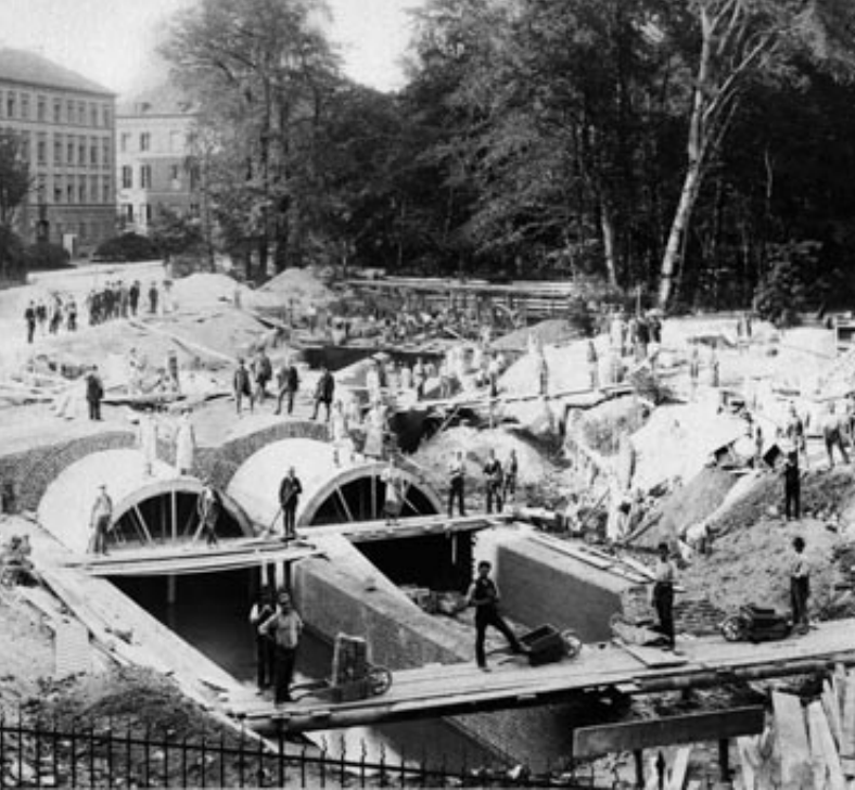
Bei der Überwölbung der Münchner Bäche, im Bild der Eisbach am Prinz-Carl-Palais, der 1890 überbaut wurde, wurden große Mengen an Ziegelsteinen verbaut.
